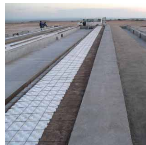
4 | Sistema de Calefacción.
