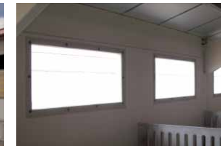
Mosquitera interior en ventanas y sujeción de separadores a cerramiento
