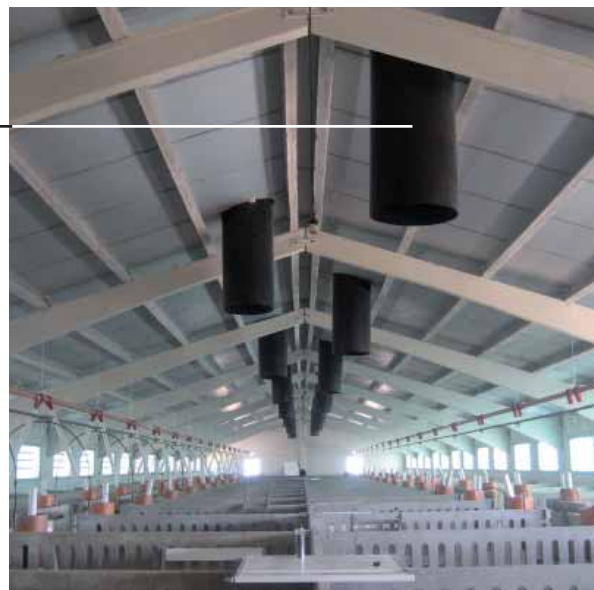
Sistema de Ventilación con Chimeneas
